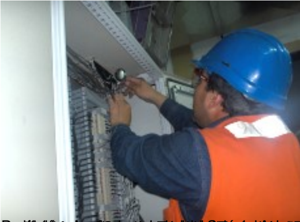
Montaje de un rack de equipos en el Centro de Control de la Alcantara SA, en el barrio de San Carlos.
