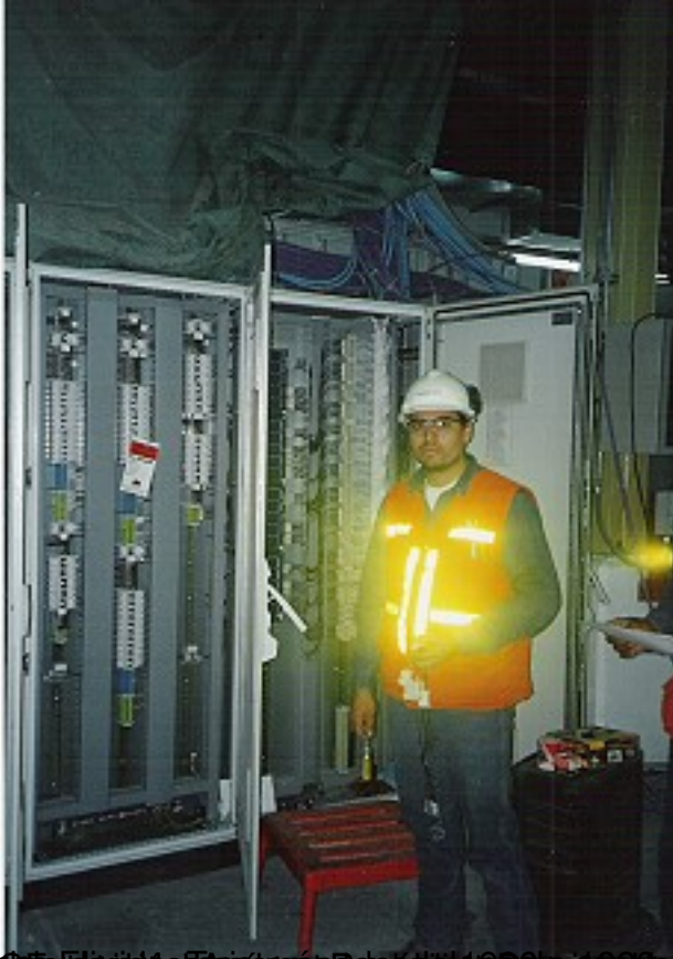
Montaje de un rack de equipos en el Centro de Control de la Alcantara SA, en el barrio de San Carlos.
